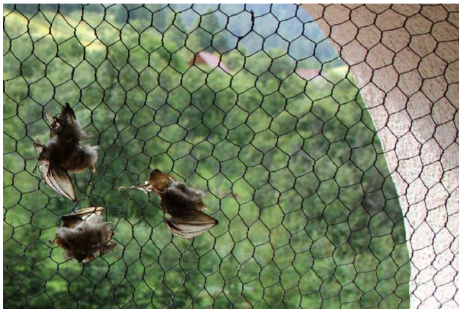
Obr. 4.4: Smutný pohľad z kostolnej veže - nevhodne uzavretý vletový otvor králičím pletivom bol pre kolóniu podkovárov malých fatálny.
