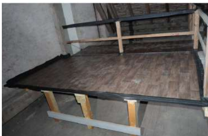
Obr. 6.7: Pôvodný stav. Guáno je na podlahe, na technickej lávke aj vo vetracích otvoroch (↑). Podporná konštrukcia pre podlážku je spojená s technickou lávkou. Z jednej strany je postavená na stojkách (stred). Zábradlie je chránené pásmom DTB fólie. Medzi podlážkou a technickou lávkou je malý výškový rozdiel, ktorý je zakrytý pásmom DTB fólie. (↓).
