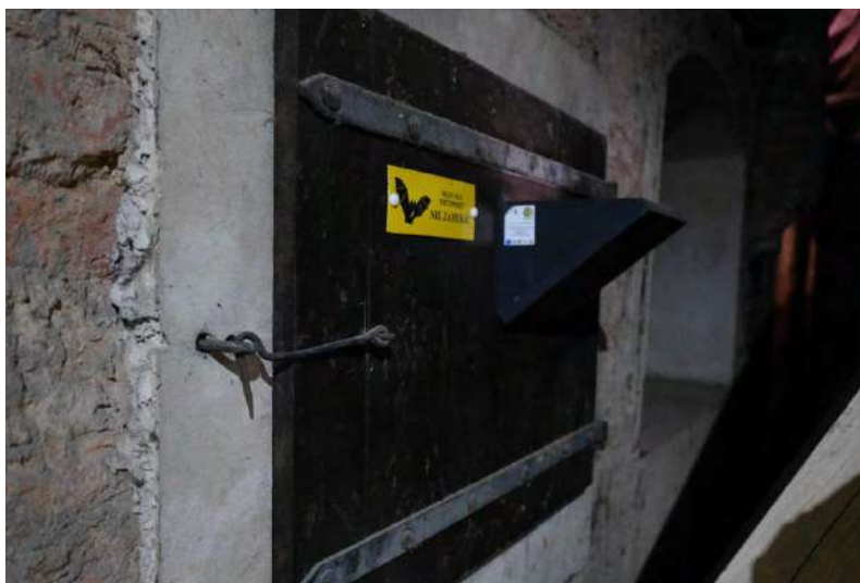
Obr. 6.44: Tieniaca clona na vletovom otvore pre netopiere. Takto pozmenený vletový otvor zároveň chráni úkryt netopierov pred vnikom predátorov (kuny, sovy) a zabraňuje vletu holubov do podkrovia.
