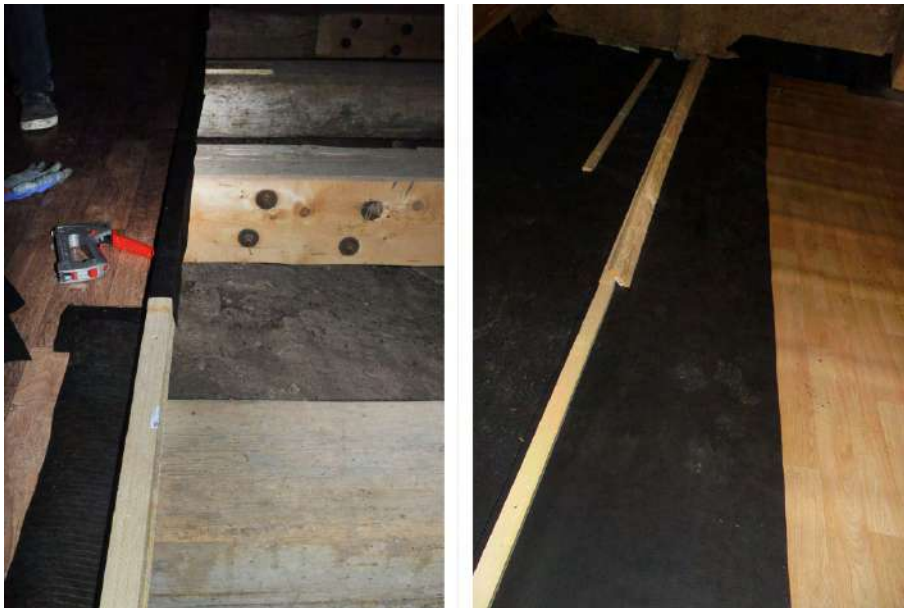
Obr. 3.12: Inštalácia zvýšeného okraja z laty 30×30mm a jej postupné balenie do DTB fólie (←). Príklad inštalácie zvýšeného okraja z laty a šikmo položenej dosky — toto celé sa potom balí do DTB fólie (→).
