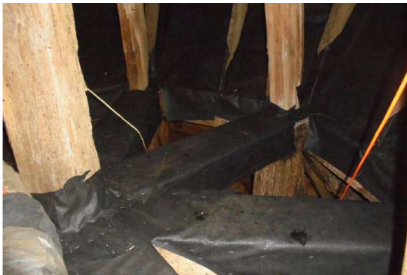
Obr. 6.11: V najvyššej úrovni veže sú trámy pokryté DTB fóliou, rovnakým spôsobom je ochránené aj debnenie cibule veže v spodnom oblúku.
