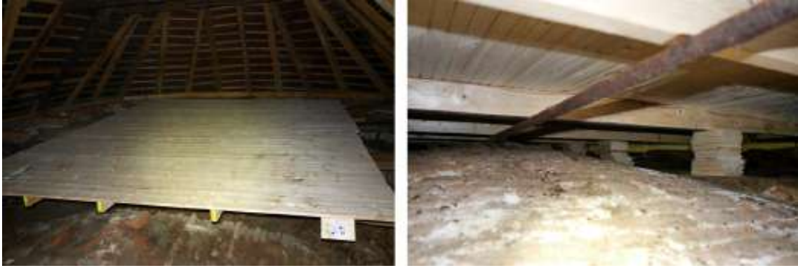
Obr. 6.27: Finálne zostavená podlážka v zadnej časti podkrovia – miesto kde sa zhromažďuje kolónia netopierov (←). Podloženie hranolov stĺpikmi z odrezkov dosiek (→).
