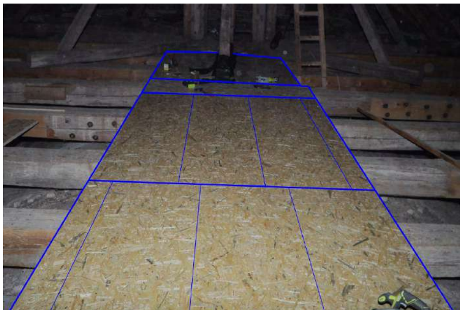
Obr. 3.9: Podlážka zložená z OSB dosiek položených na väznice v podkroví kostola. Môžete si všimnúť, že na šírku sú použité tri celé dosky a jeden úzky prúžok — ten je raz umiestnený sprava a potom zľava podlážky tak, aby na seba nenadväzovali jednotlivé pozdĺžne spoje dosiek. Rez dosky môže byť len na okraji podlážky.
