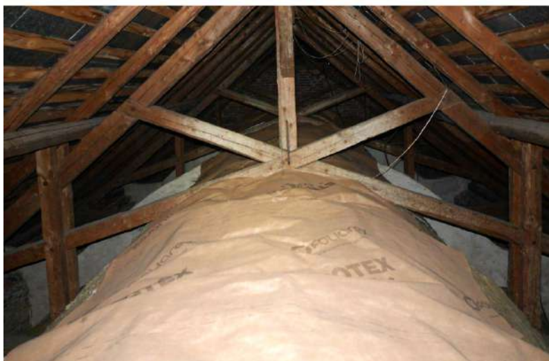
Obr. 6.29: Pôvodný stav znečistenia izolácie od guána. Čistenie tohto priestoru je prakticky nemožné (↑). Voľne položená paropriepustná fólia, ktorá oddelí padajúce guáno od izolácie a uľahčí čistenie do budúcnosti (↓).
