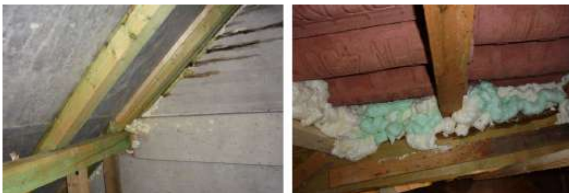
Obr. 6.16: Všetky škáry sme utesnili pomocou polyuretánovej peny, a to aj medzi štítom a škridľami. Takto sa netopiere nemôžu v žiadnom prípade dostať do priestoru podkrovia.
