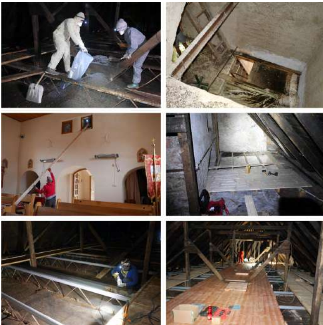
Obr. 6.23: Pôvodný stav podkrovia. Fólia v zadnej časti podkrovia slúžila pôvodne na záchyt guána. Zabraňovala však potrebnej cirkulácii vzduchu a kondenzovala a spôsobila čiastočne zvlhnutie izolácie. Bola odstránená a nahradená podlažkou. Dosky dlážkovice boli vykladané do veže cez malé okno. Hrdzavejúce konštrukcie boli očistené drôtennými kefami a ošetrené antikoróznym náterom. Nad vstup do veže bola do výšky inštalovaná podlažka zo smrekovej dlážkovice o ploche viac ako 70 m 2 . Jej súčasťou sú dva servisné otvory.
