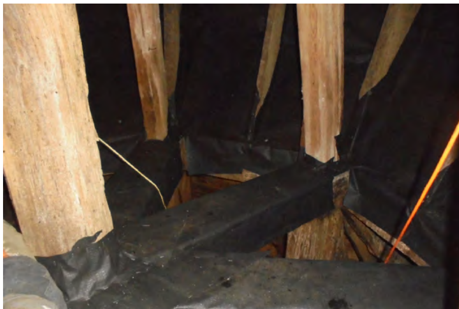
Obr. 3.18: Príklad použitia DTB fólie na ochranu miest vo veži, kde dopadá netopierí trus. Okrem horizontálnych trámov ondrejského kríža je touto fóliou zakrytá aj spodná časť vnútrajška cibule veže.
