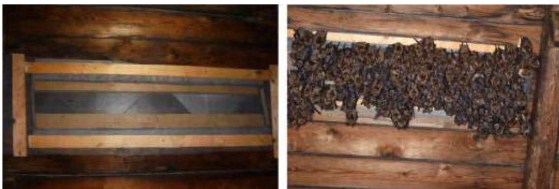
Obr. 6.18: Dokončené prevetrávanie, kde je moskytiéra zaistená latami k pôvodnému debneniu. Už pri inštalácii bol cítiť chladný prúdiaci vzduch (←). Netopierom sa toto opatrenie očividne páči (→).
