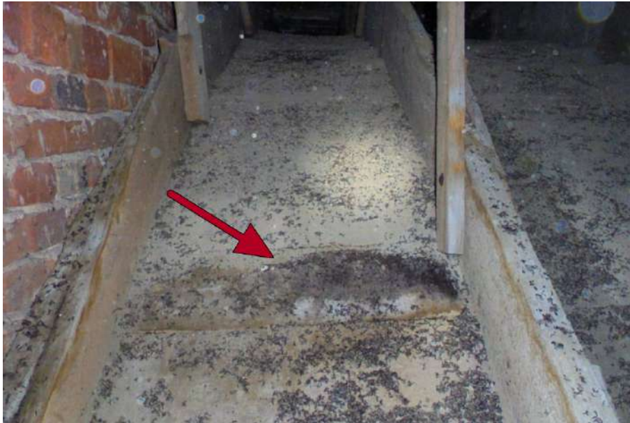
Obr. 1.1: Zle presychajúca vrstva trusu na drevenej klenbe kostola. Kostolná drevená klenba sa nachádza pod podlahou podkrovia. V tomto kostole sa nachádza početná kolónia podkovára malého o veľkosti približne 200 samíc. Akékoľvek opatrenia sú v takomto priestore zložité, pretože po drevenej klenbe nie je možné chodiť. Jediné, čo človeka bezpečne unesie, je murovaná rímsa po okraji múru a drevené rebrá z fošní.
