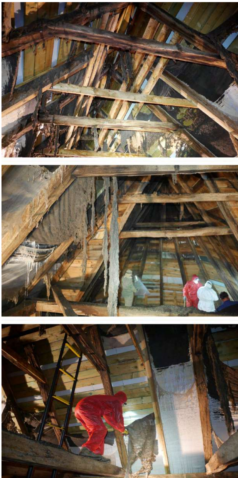
Obr. 6.49: Veľké kolónie netopiera veľkého majú výrazne negatívny vplyv na podkrovia, kde sú pod strešnou krytinou natiiahnuté paropriepustné fólie. Tie zároveň predstavujú veľké riziko pre netopiere – pazúrkami ich neúmyselne trhajú, a do takto poškodených zdrapov sa zachytávajú. Najmä pri mláďatách sa často stáva, že sa úplne zamotajú a uhynú. Toto je príklad silného poškodenia fólií v podkroví kostola kolóniou netopiera veľkého, o veľkosti 2500 samíc s mláďatami. Poškodené fólie bolo nutné odstrániť (Sačurov; SK).
