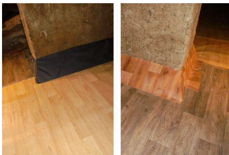
Obr. 3.14: Komín chránený pomocou šikmo uložených dosiek - tie sú okolo celého komína (←). Dosky sú potiahnuté DTB fóliou, na ktorej je ešte upevnený pruh linolea (→).
