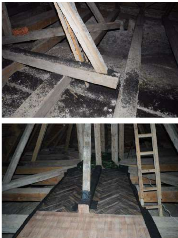
Obr. 6.3: Stav pred realizáciou opatrení okolo oporného trámu vežičky (↑). Dokončená podlážka — stredový oporný trám, rovnako ako zvýšený okraj podlážky sú zabalené do DTB fólie — plochu chráni linoleum (↓).
