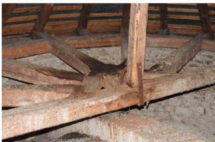
Obr. 6.30: Pôvodný stav znečistenia izolácie guánom. Čistenie tohto priestoru je prakticky nemožné.
