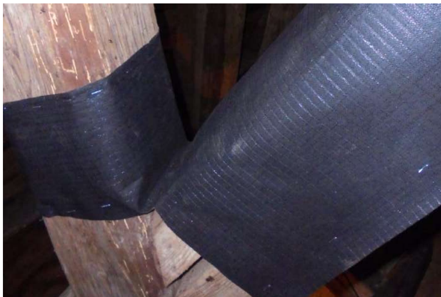
Obr. 3.17: Aj takto je možné veľmi jednoducho ochrániť úžľabie trámu pomocou DTB fólie.
